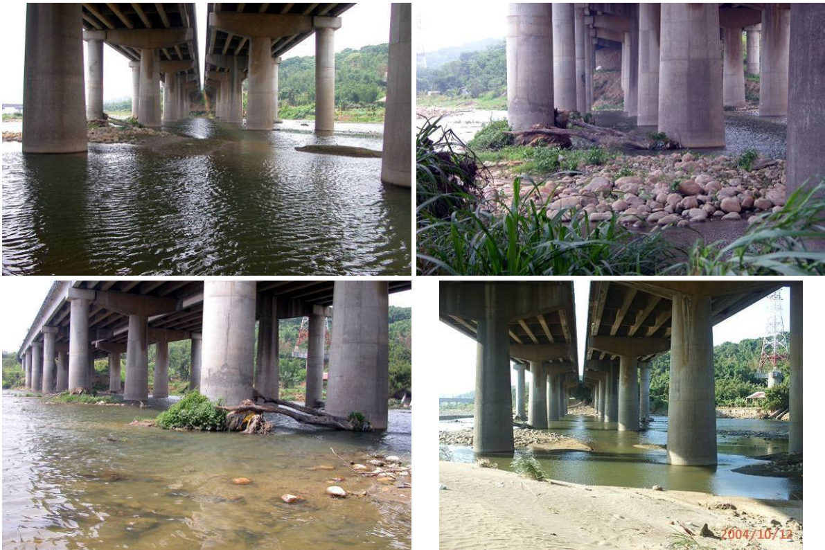
圖 4.1-11 國道一號 87K+809 鳳山溪橋現況照片及歷年河床變化圖
