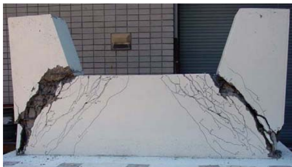
止震塊「預期性」損壞模式
