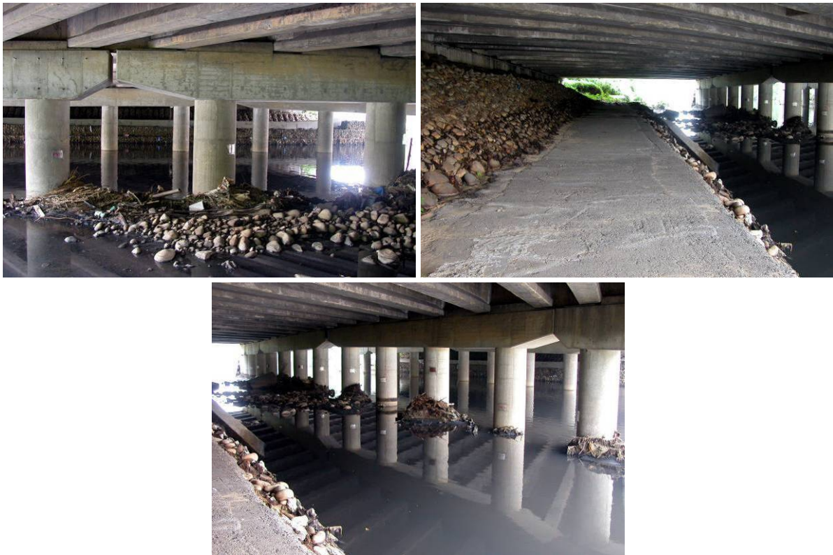
圖 4.2-1 國道一號 49K+505 南崁溪橋現況照片及歷年河床變化圖
