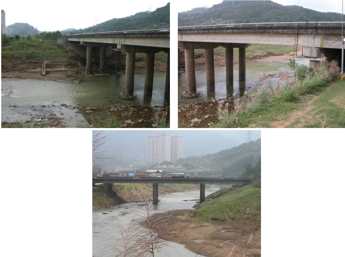
圖 4.1-2 國道一號 7K+384 基隆河一號橋現況照片及歷年河床變化圖
