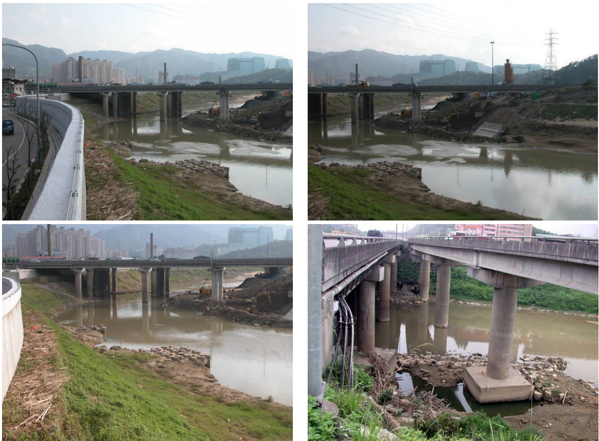
圖 4.1-4 國道一號 10K+938 基隆河三號橋現況照片及歷年河床變化圖
